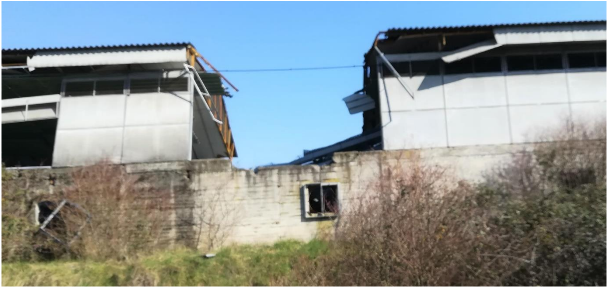
Vue d'un bâtiment en ruine
